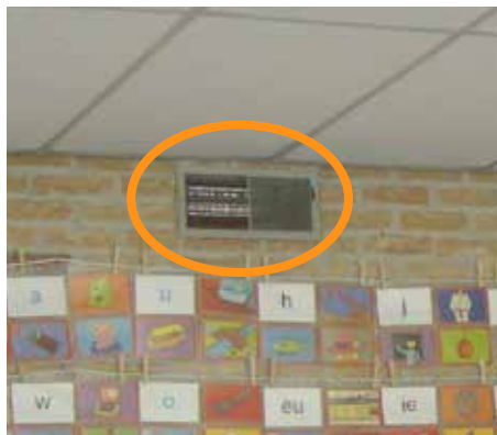
Figuur 5: Ventilatieroosters tussen verblijfsruimte en gang, in de muur (links) en in het raam (rechts) - bron: W/E adviseurs
