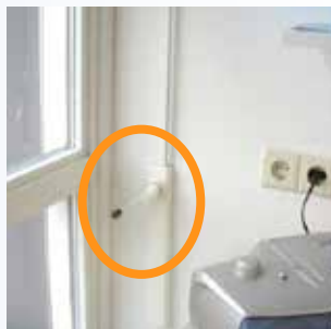
Figuur 1: Voorziening voor het traploos openen van ramen (links en midden), omkasting achter klepraam, GGD-variant concept frisse school (rechts) - bron foto links: W/E adviseurs, bron foto midden: AXA, bron foto rechts: 'Bouwfysica, nr 4' 2009 blz. 31
