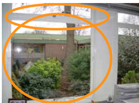
Figuur 2: Toe- en afvoer: klepramen en grote te openen ramen (linksboven), overstroomvoorziening tussen groepsruimte en gang (rechtsboven), mechanische afvoer in ganggebied (onder) - bron: W/E adviseurs
